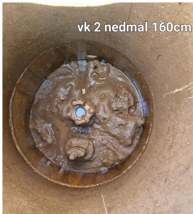
Figur 16: Bilder fra befarings 08. mai 2023. Eksisterende kum.
