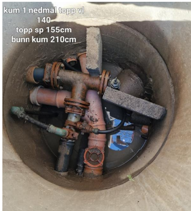
Figur 15: Bilder fra befarings 08. mai 2023. Eksisterende kum.
