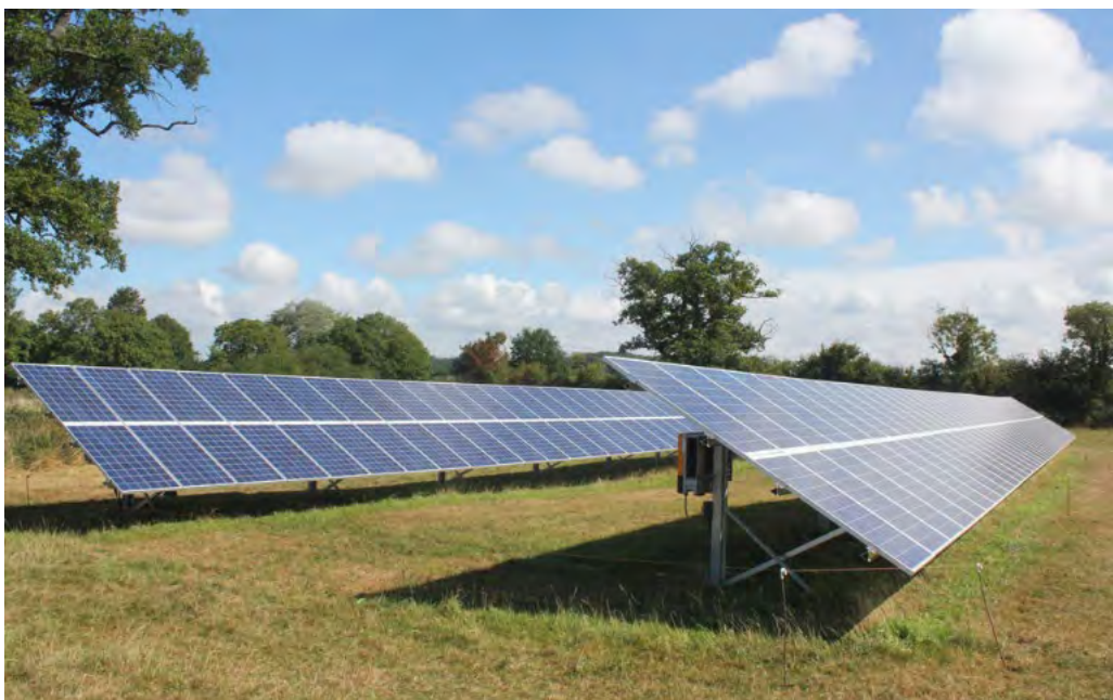
Typisk installasjon, rekke med solcellepaneler
