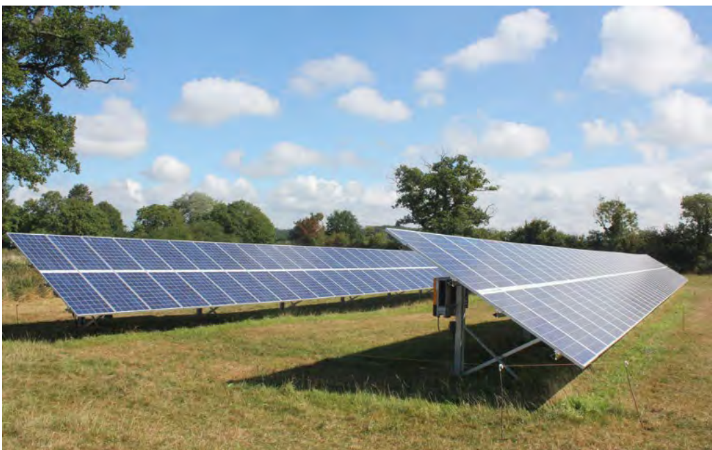
Typisk installasjon, rekke med solcellepaneler
